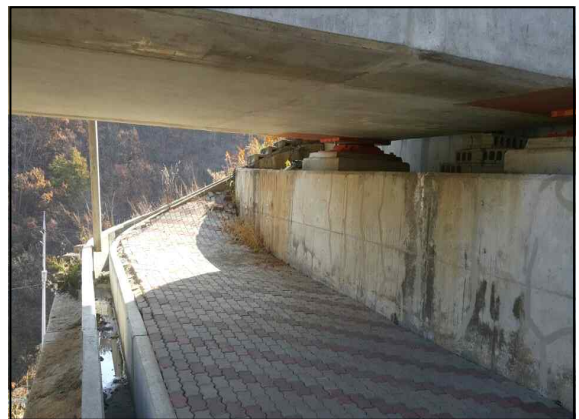
교대 콘크리트 표면열화(A2)
