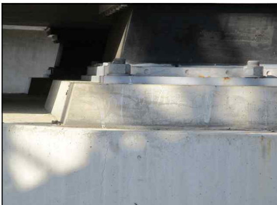
받침콘크리트 균열(P4 SH2)
