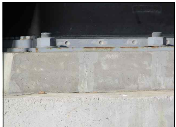
받침콘크리트 균열(P5 SH2)
