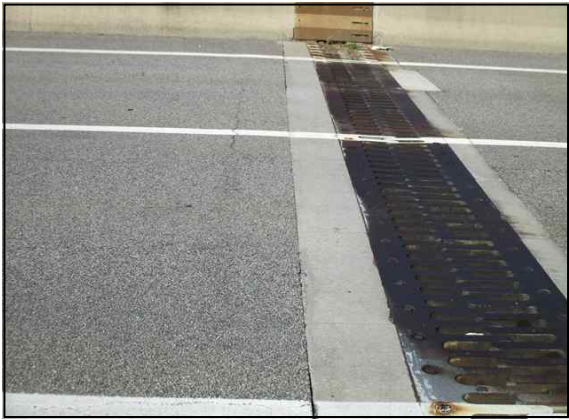
신축이음 후타재 균열(A1)
