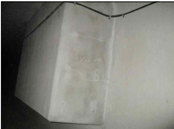
거더 내부 정착구 균열(S6)
