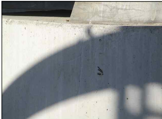
교각 기둥 균열(P4)
