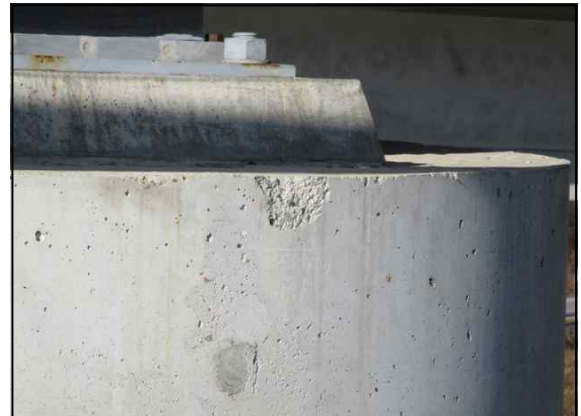
교각 기둥 파손(P7)
