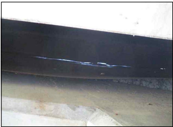
신축이음 본체 고무재 파손(A1)
