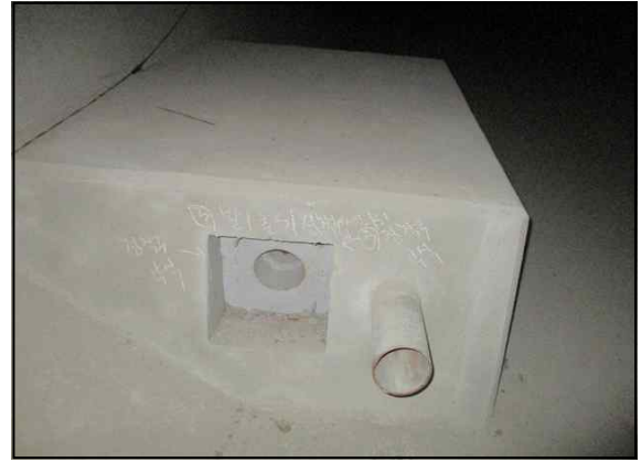
거더 내부 정착구 부식(S1)
