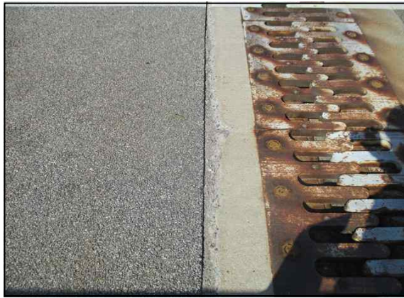
신축이음 후타재 파손(A2)
