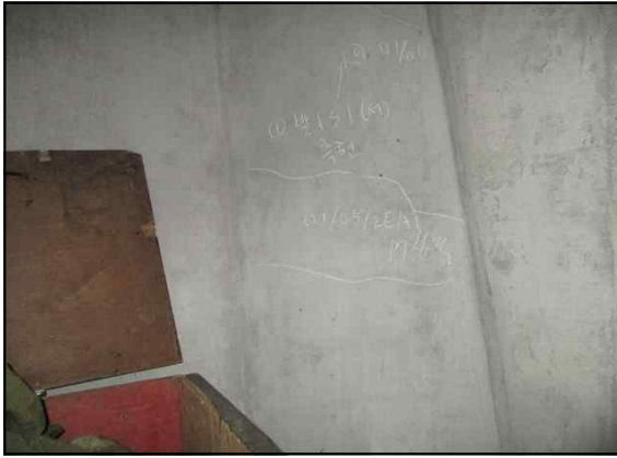
거더 내부 균열(S1)
