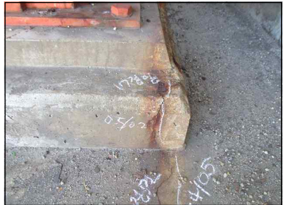
받침콘크리트 균열(A1 SH1)
